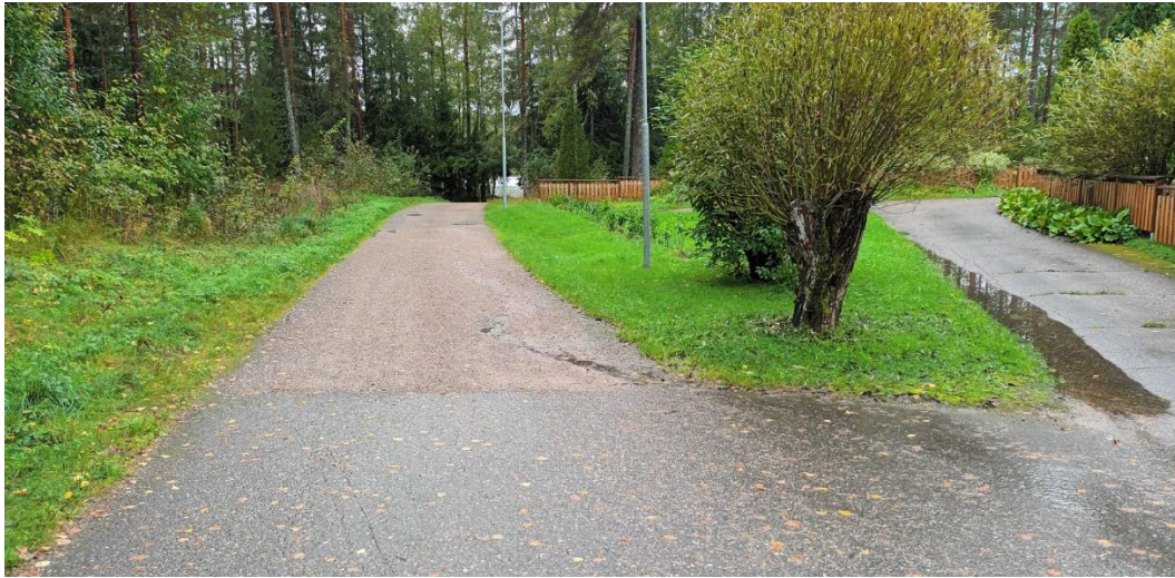
Kuva 9. Yleiskuva Kullervontien loppupäästä kohti Tiilijärvenraittia katsottuna. Sorapäälysteisellä väylällä vesi virtaa väylää pitkin aiheuttaen eroosiota. Väylän oikealla puolella olevalla viheralueella on matala painanne, jota tulisi parantaa, jotta vesi virtaisi jatkossa painanteessa. [Ramboll 17.9.2025]
