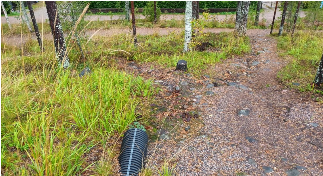
Kuva 15. Kalevantien purkupäässä on havaittavissa huomattavaa eroosiota. [Ramboll 17.9.2025]
